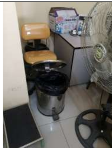
Foto 12: Diagnóstico In Situ – Unidad de Servicios de Salud, Servicio de odontología – tacho en malas condiciones
