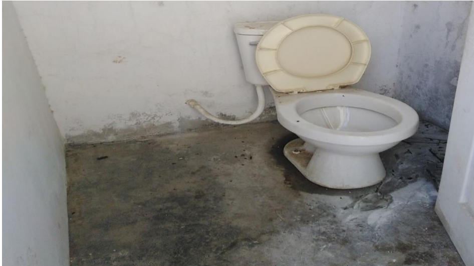
Fotografía 17. Servicios Higiénicos en mal estado
