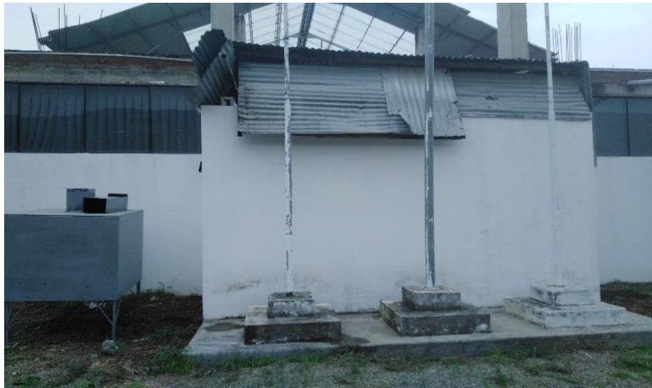
Fotografía 13. Infraestructura por donde filtra el agua hacia la edificación.
