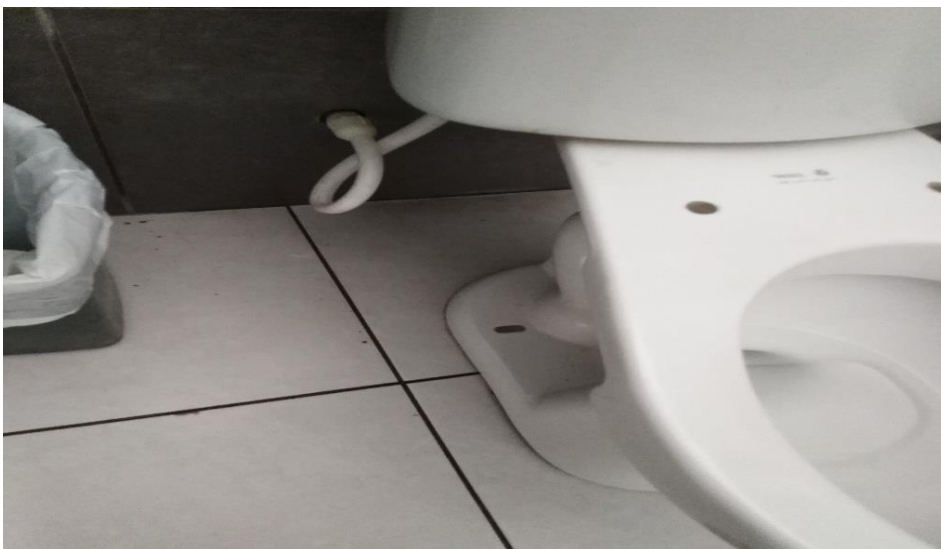
Fotografía 06. Tubos de abasto de inodoro
