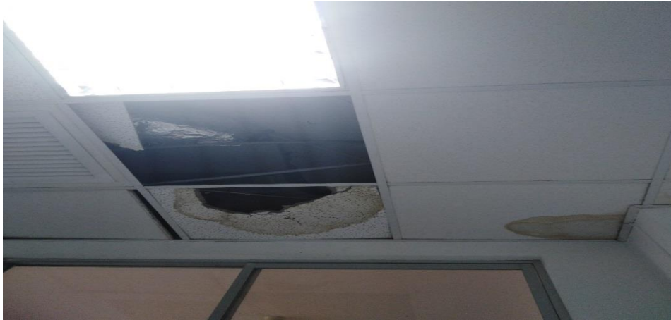
Fotografía 01. Baldosas para cielo raso deterioradas
