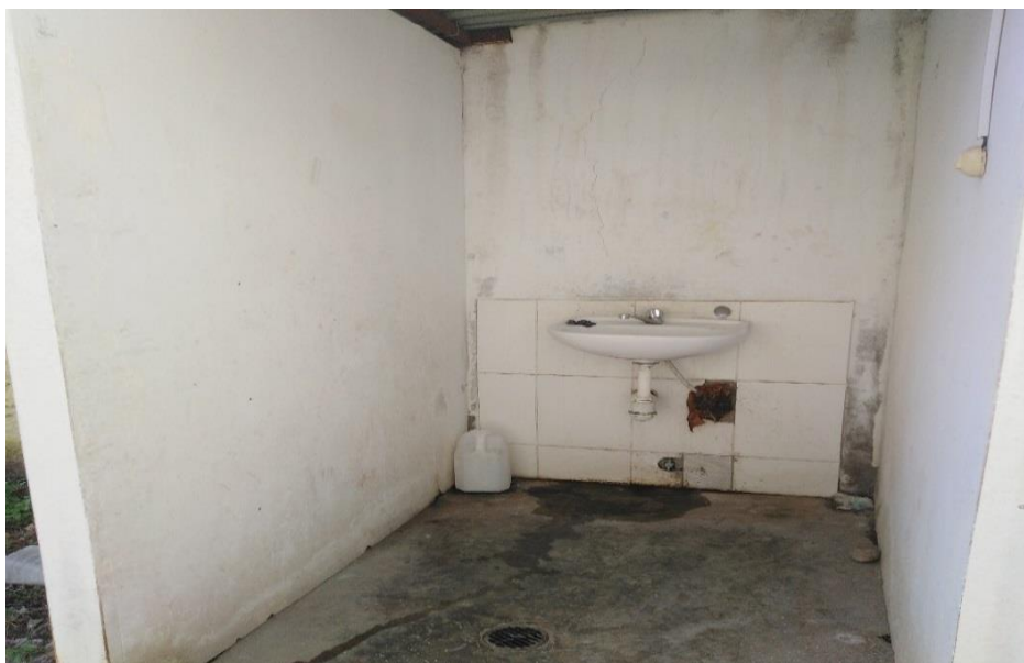
Fotografía 16. Servicios Higiénicos en mal estado
