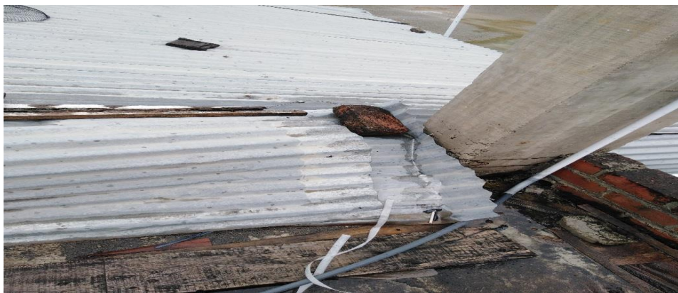
Fotografía 09. Techos de escaleras por donde se filtra el agua.
