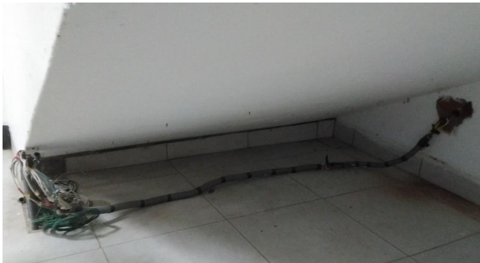
Fotografía 03. Cables de electricidad expuestos
