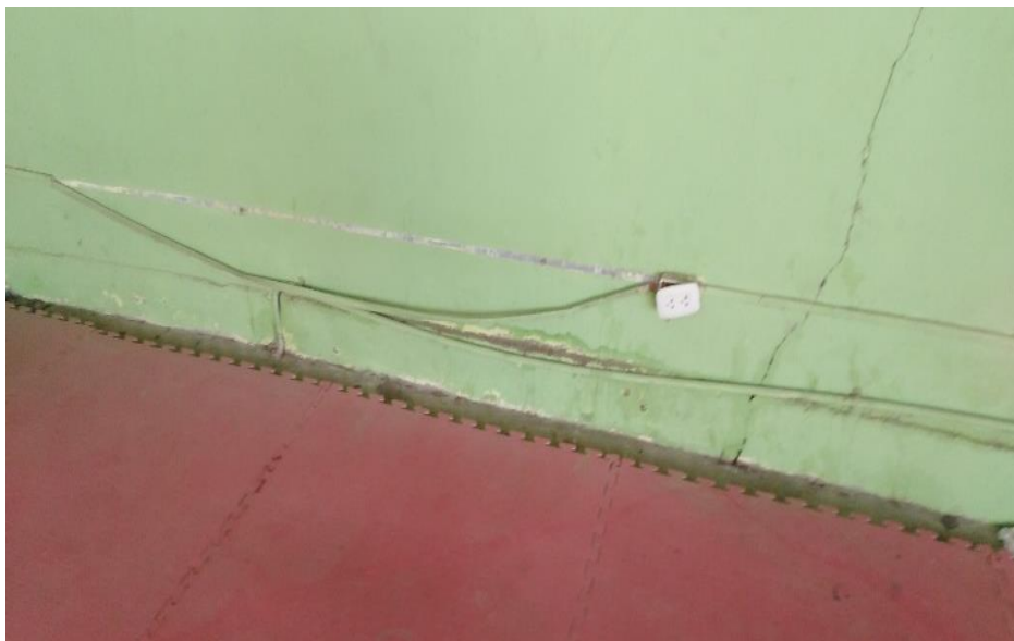
Fotografía 15. Cables eléctricos expuestos y tomacorrientes deteriorados
