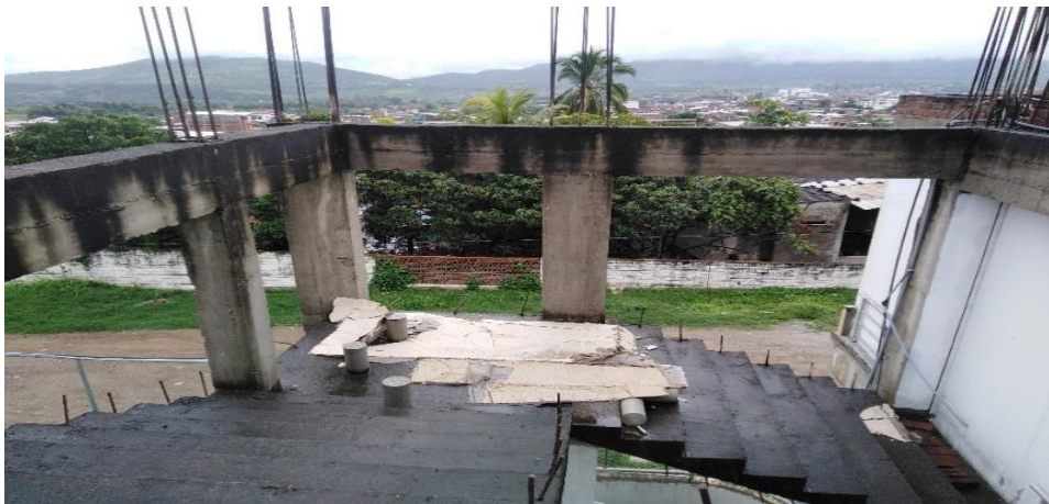
Fotografía 08. Escaleras que no cuentan con techo por lo cual ingresa la lluvia
