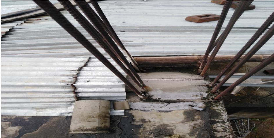
Fotografía 07. Techo de las escaleras en deterioro
