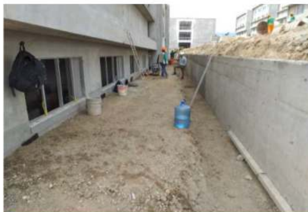
Vista Fotográfica de trabajos de relleno con material propio seleccionado en sub drenaje
