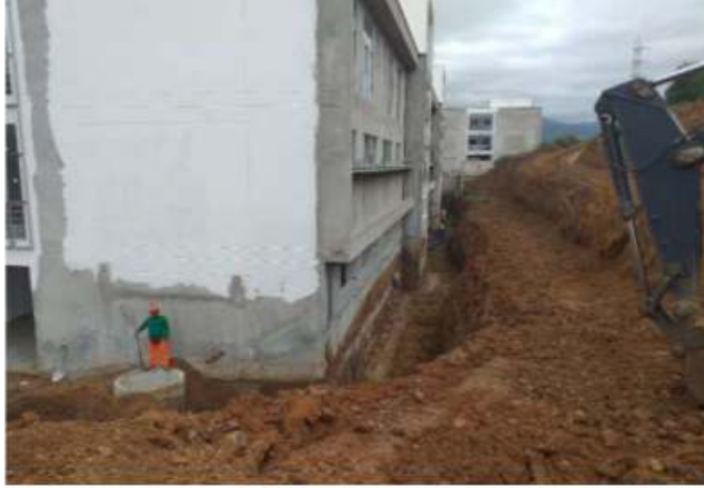
Vista Fotográfica de excavación de zanja para trabajos de Sistema de Sud Drenaje
