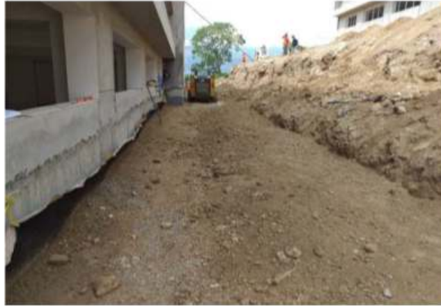
Vista Fotográfica de trabajos de relleno con material propio seleccionado en sub drenaje
